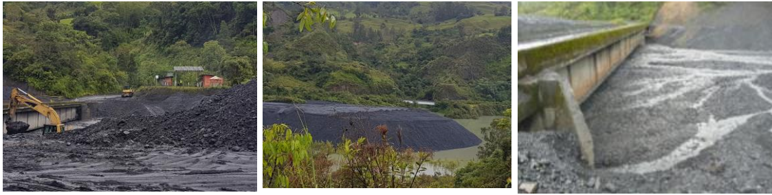
Figura 22. Sedimentos quebrada Moncabita. Vía Ubalá – Gachalá.
