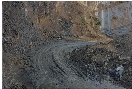
Figura 21. Vía Ubalá – Gachalá. Derrumbe sobre la vía. Fuente. Propia. 2018
