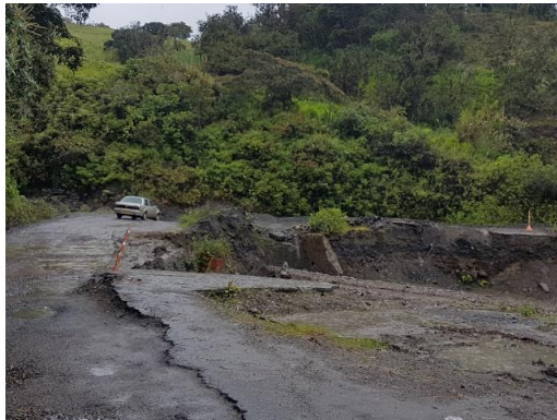
Figura 20. Vía Ubalá – Gachalá. Deslizamiento de la banca. Fuente. Propia. 2018
