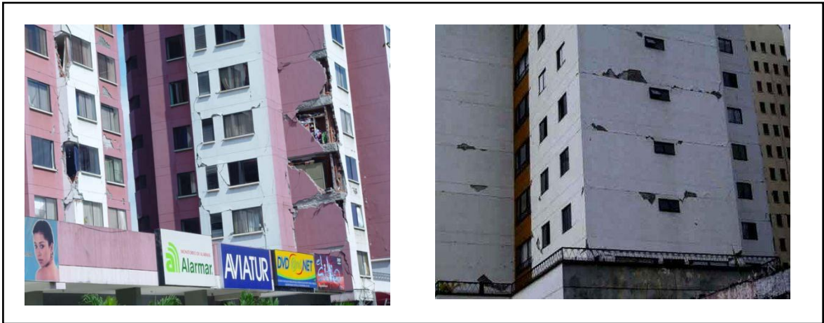
Figura 10. Edificaciones afectadas causas por sismos en Santiago de Cali Fuente: www.elpais.com.co
