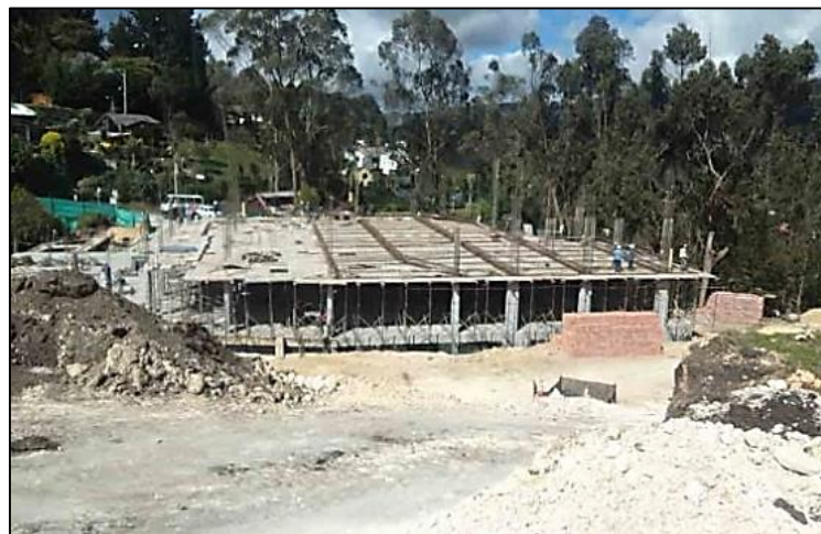
Figura 15. Obra centro comercial sobre la vía principal del municipio (Recuperado de www.elspectador.com / Cortesía CAR. La CAR suspendió la construcción del centro comercial El Manantial, de 1.459 metros cuadrados, por estar ubicado en zona de reserva forestal.
